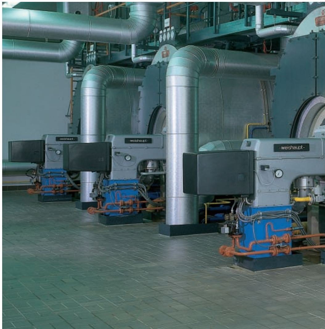
Теплоцентрль с комбинированными горелками WKGL 50 и WKGL3 - общая мощность 28 МВт
